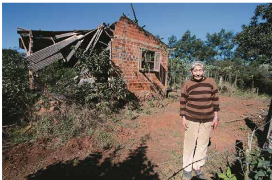
Carolina: impacto das detonações danifica casas e tira o sono dos moradores
